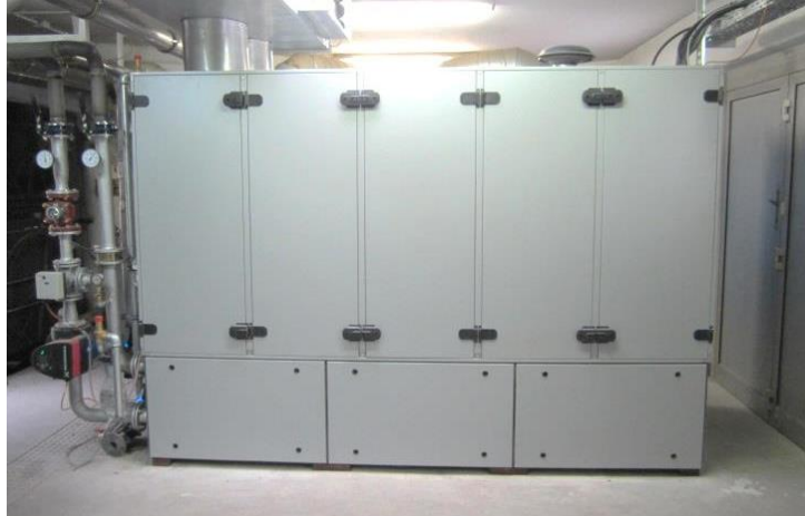
Blockheizkraftwerk KA Taunusstein-Bleidenstadt
